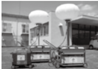
宝くじの助成金で整備した「投光器」と「発電機」
