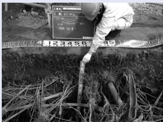
▲ケヤキ柵内の西側を深さ2.5m試掘したところ、元気な根が多数見つかりました。今後土壌を改良して根を維持する必要があります。
