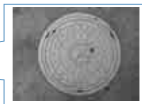
▲公共汚水ます
