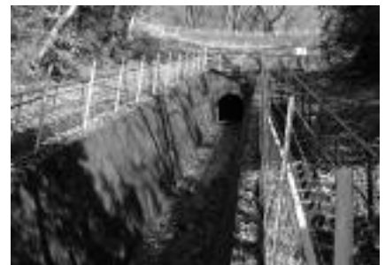
⑥水槽余水路
