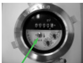
水道の蛇口が閉まっている状態でこの部分が回っていると漏水の可能性があります。
