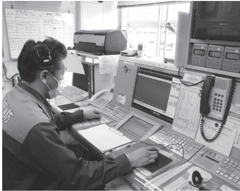
現在デジタル化に向け整備が進められているアナログ消防通信指令台
