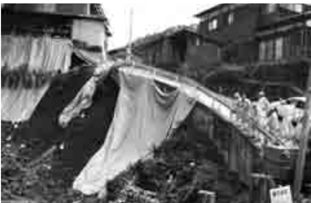
台風 6 号による災害現場（島田地区田野入）
