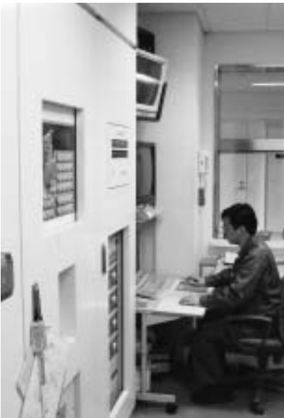
市庁舎中央管理室
