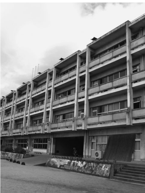
耐震化が予定されている上野原小学校
