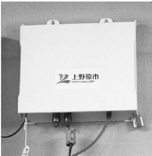
設置された集端ボックス
