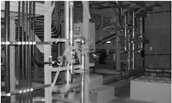
桂川流域下水道松留中継ポンプ場内部の設備
