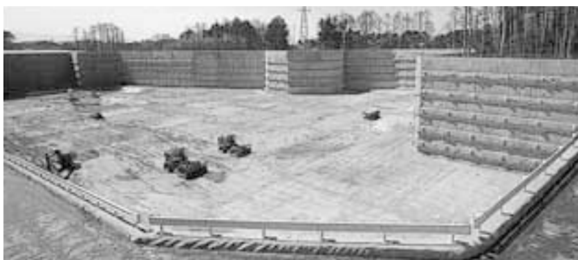
上野原市の焼却残渣が運び込まれる、最終処分場
