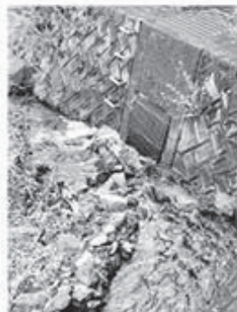
水道の取出口
